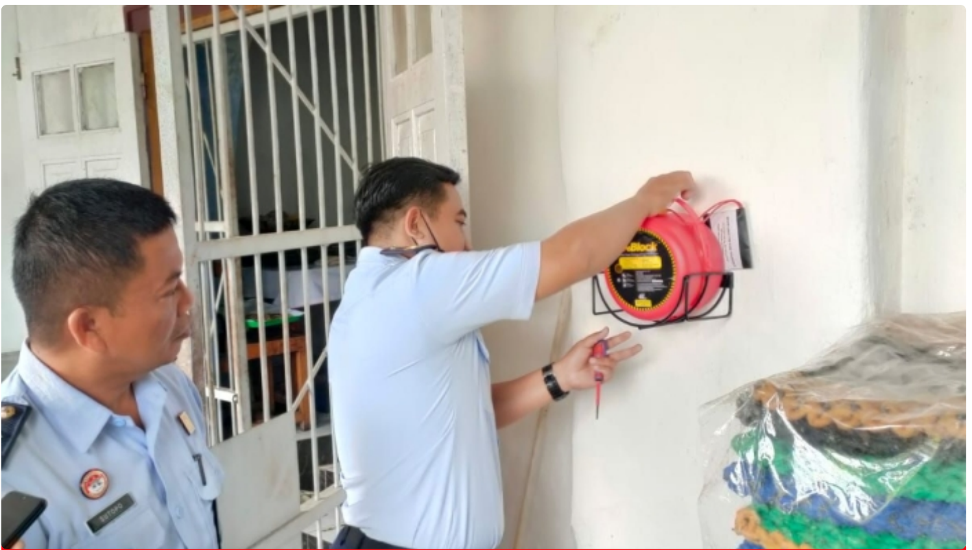
Antisipasi Kebakaran, Lapas Ambarawa lakukan Pemasangan APAR
